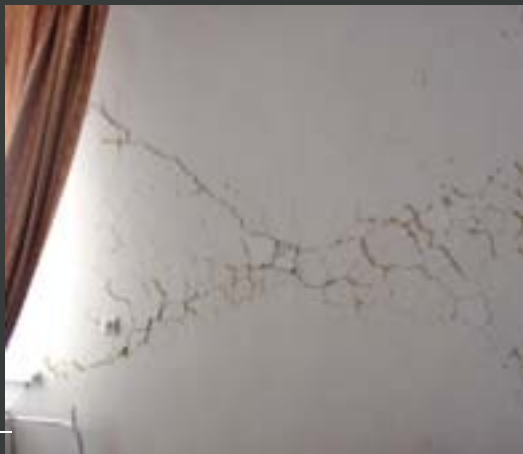
Stopień V – Krzyżowe pęknięcia ściany konstrukcyjnej
