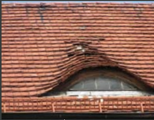
Stopień III – Duże rozluźnienia i uszkodzenia dachówek
