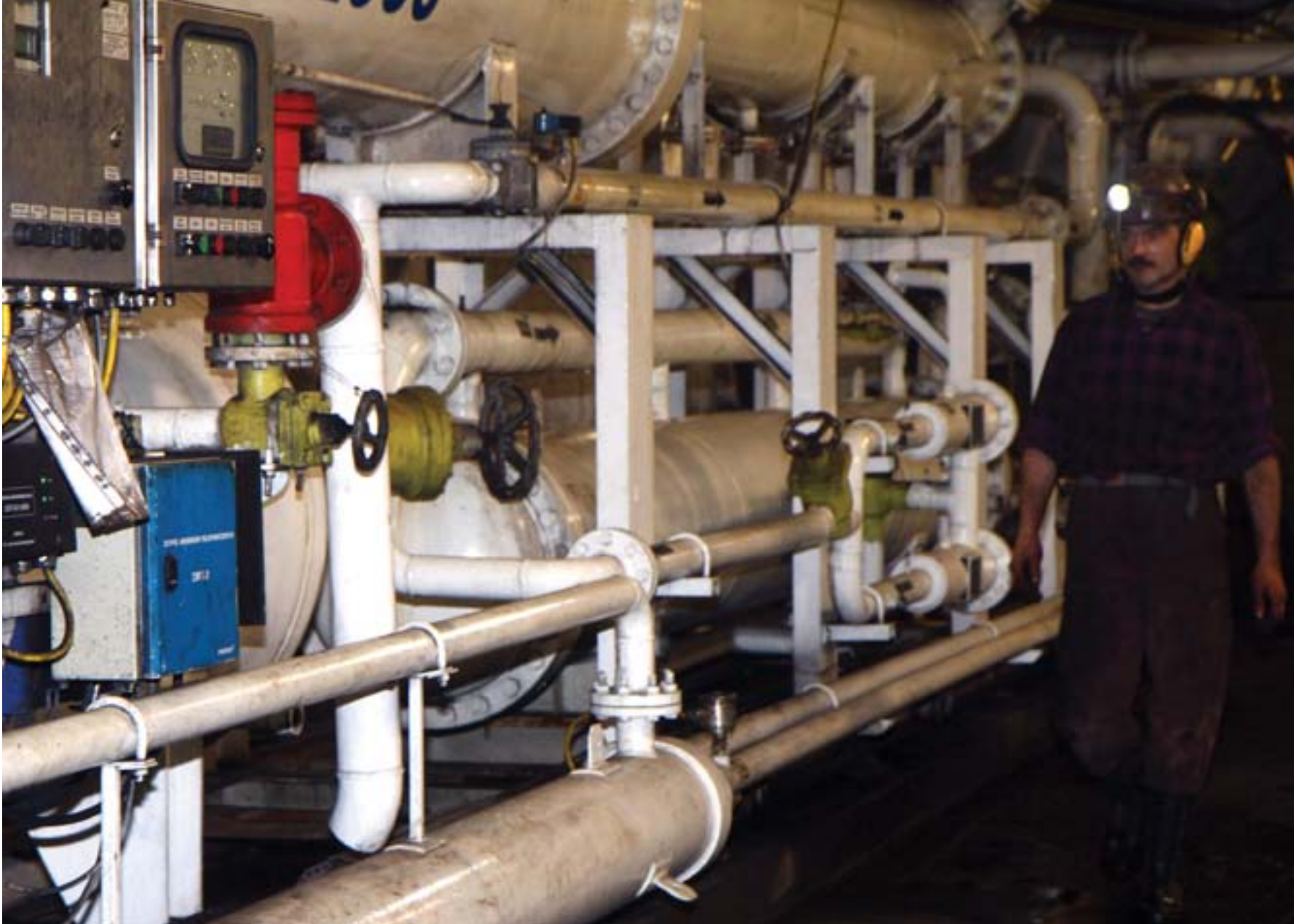
W kopalniach o dużym i bardzo dużym zagrożeniu klimatycznym stosuje się urządzenia klimatyzacji grupowej. Na zdjęciu: instalacja w kopalni „Bielszowice”.
