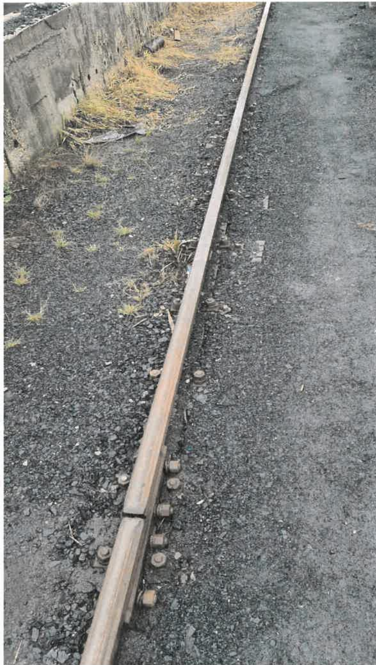
Rys 9. Widok placu składowego – wyeksploatowane i zniszczone podkłady drewniane, braki łączników w połączeniach szyn
