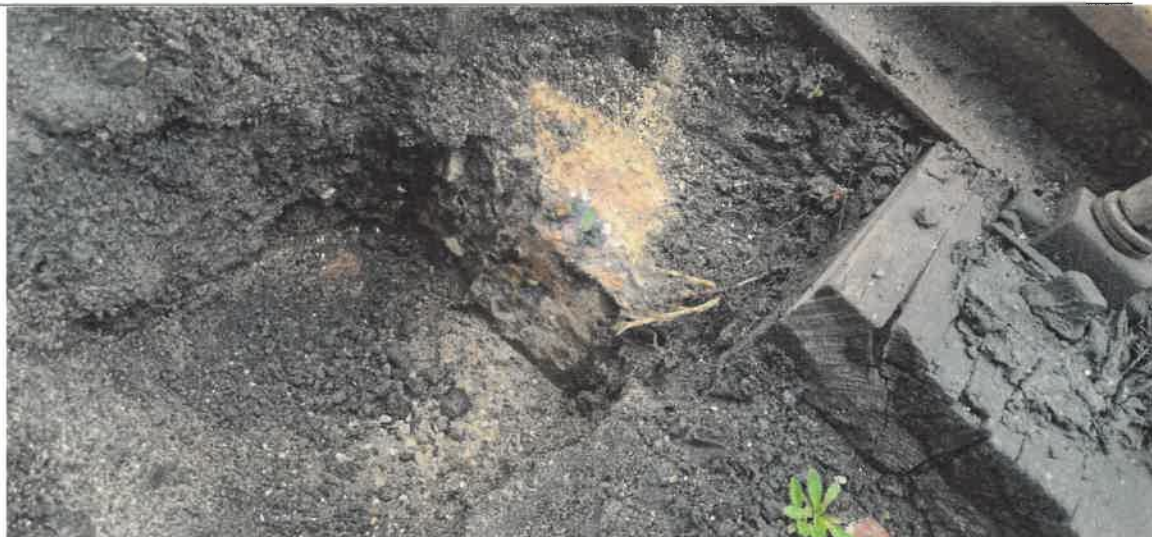
Rys 7. Miejsce odkrytki – widoczne skruszone miejsca zapraw wyrównujących
