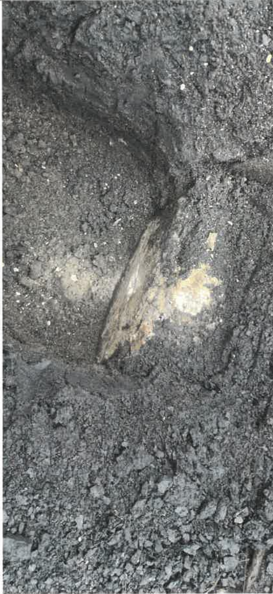
Rys 6. Miejsce odkrywki – widoczne skruszone miejsca zapraw wyrównujących
