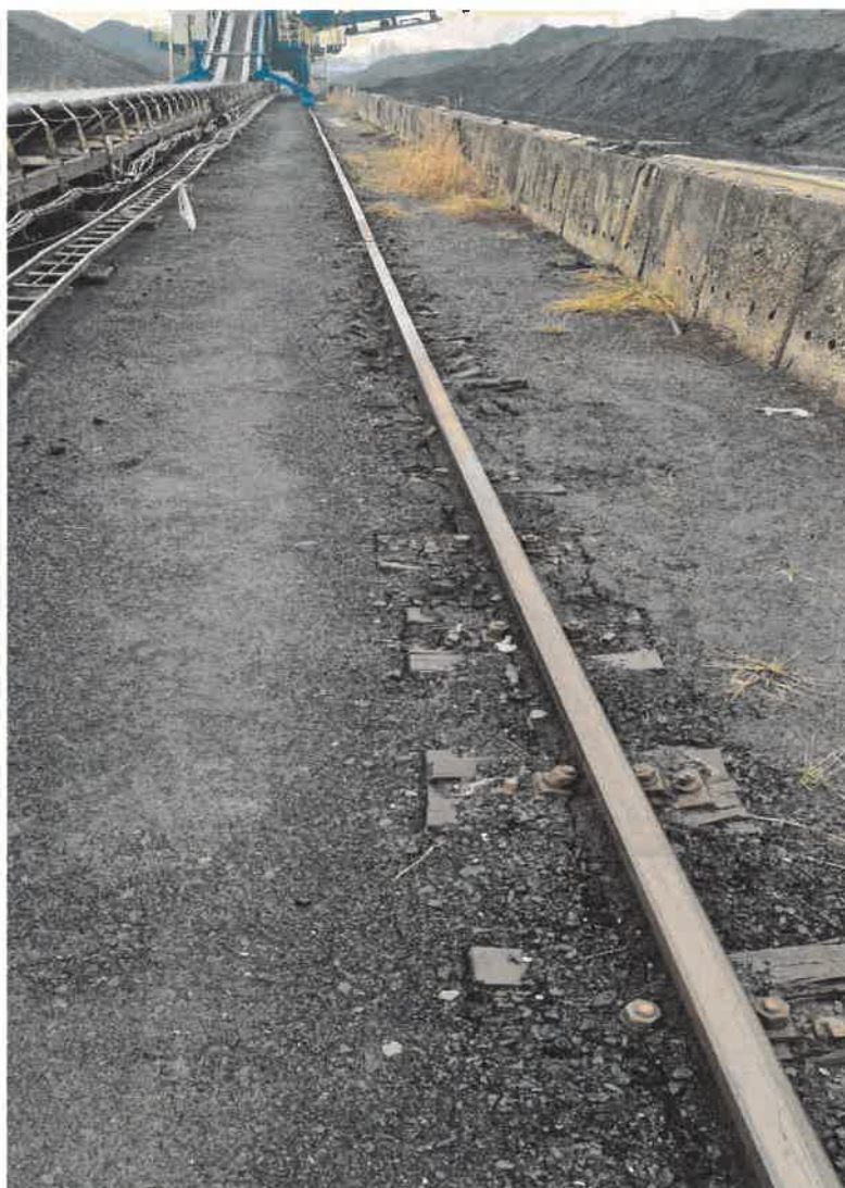
Rys 8. Widok placu składowego – wyeksploatowane i zniszczone podkłady drewniane
