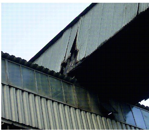
Zdjęcie 4 – ubytki w obudowie - górna część mostu 1.12 nad mostem AB (P-12)
