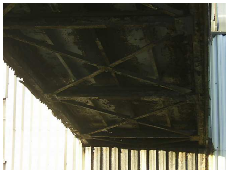
Zdjęcie 6 – spód mostu od strony Płuczki c.c. – widoczna korozja blach żeberkowych, pasów dolnych, belek poprzecznych i podłużnych stropu mostu
