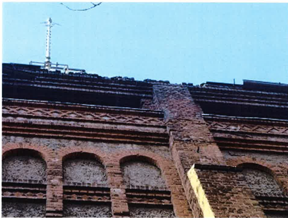
Fot. 16. Uszkodzone i brakujące rynny
