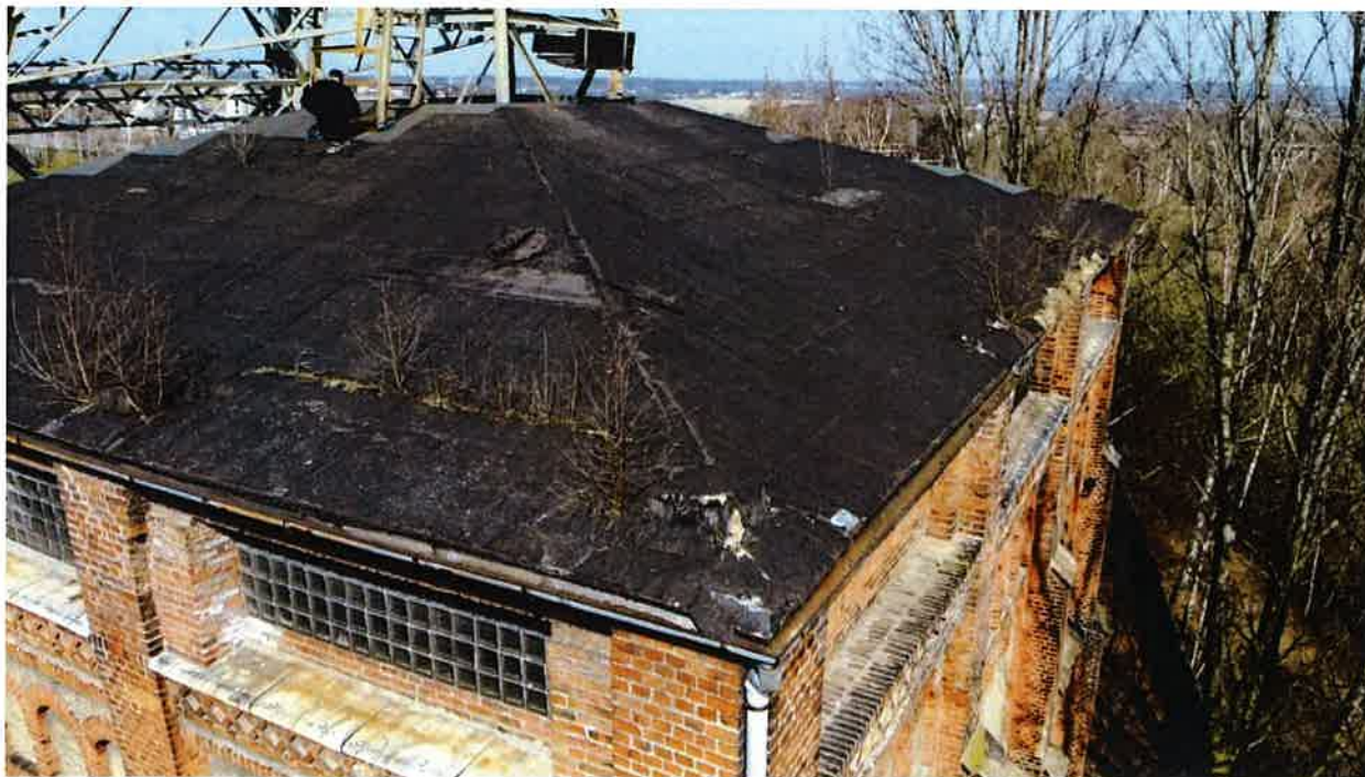
Fot. 13. Uszkodzone i nieuszczelne pokrycie dachowe
