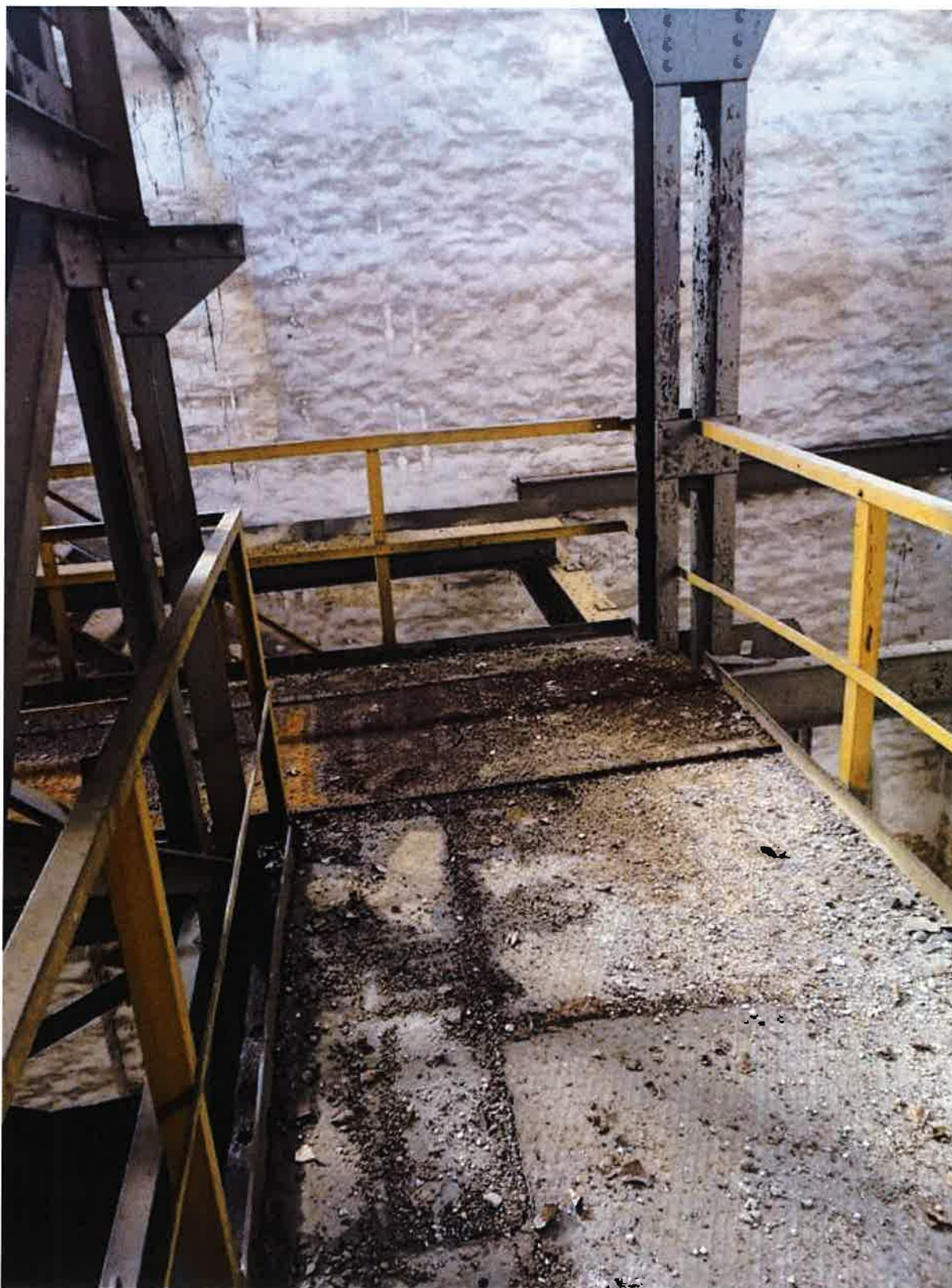
Fot. 19. Skorodowane podesty stalowe
