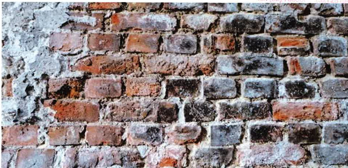
Fot. 23. Uszkodzone i odspojone fragmenty tynków wewnętrznych
