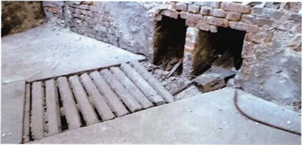
Fot. 6. Kanał kablowy
