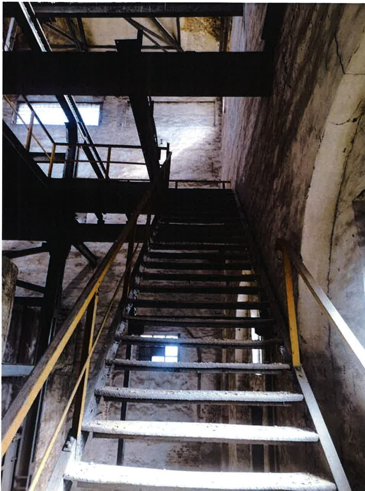
Fot. 20. Odształcone stopnie schodów stalowych
