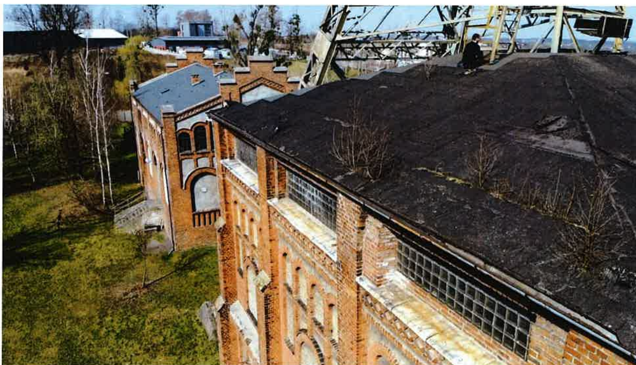
Fot. 14. Uszkodzone i nieuszczelne pokrycie dachowe
