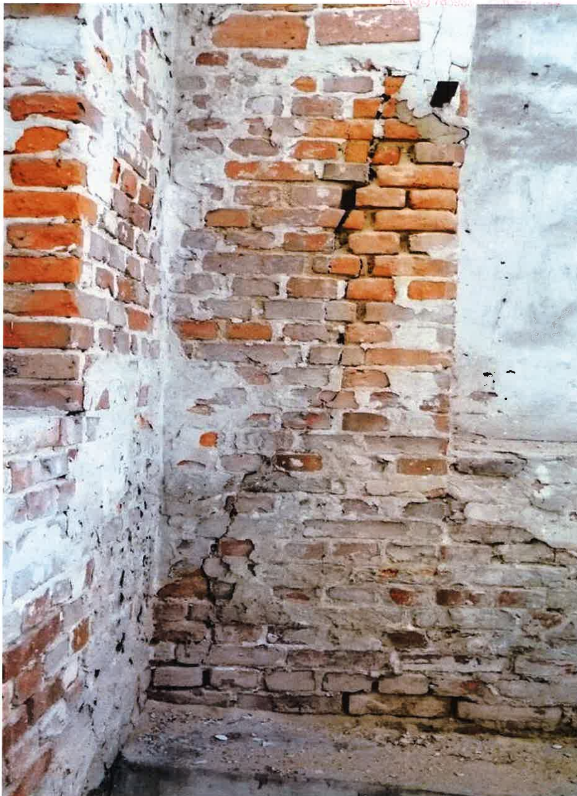
Fot. 22. Uszkodzone i odspojone fragmenty konstrukcji murowanej
